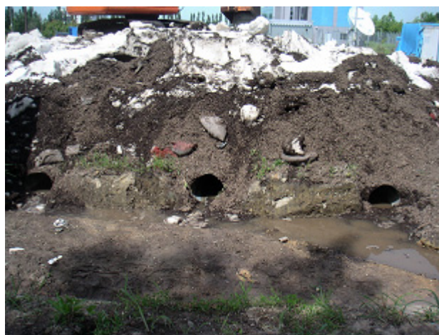
画像 4-8 冷気回収のためのダクト出口
