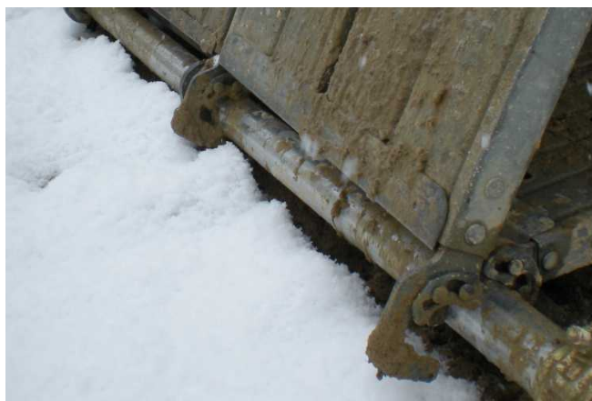
図-18 足場板の接続不良②
