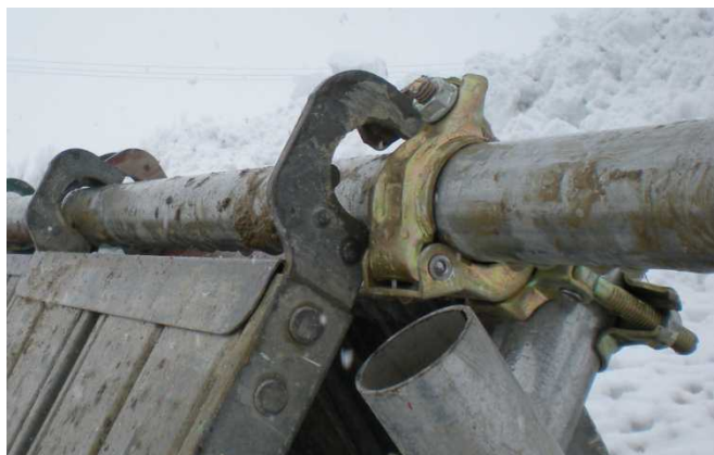
図-17 足場板の接続不良①
