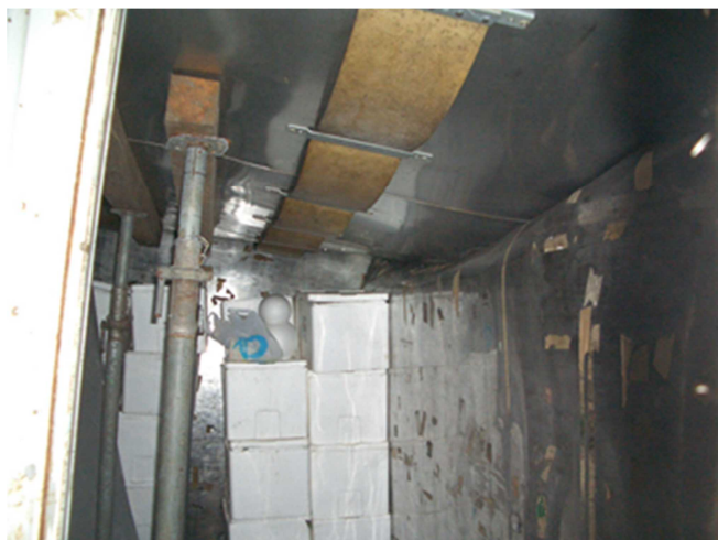
図-8 コンテナ天井部の変形 (4月)
