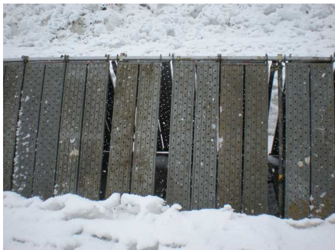
図-16 足場板間の隙間
