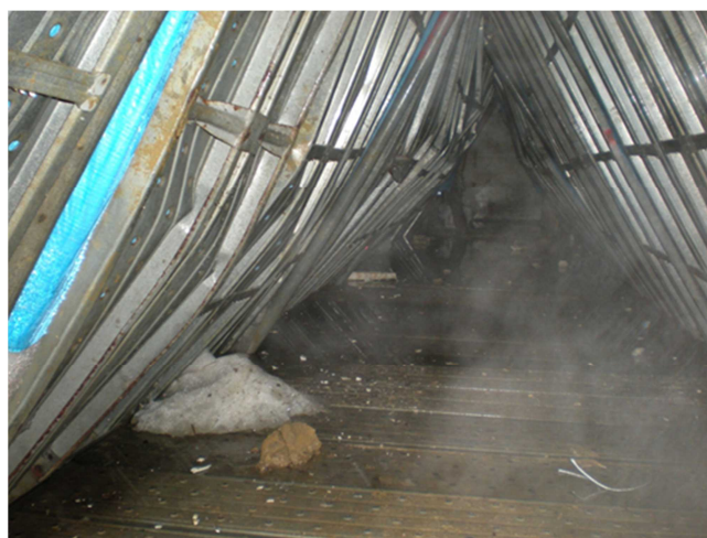
図-11 三角通路部分の変形
