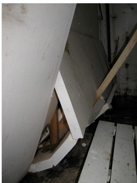
図-9 接続部分の破損 (4月)
