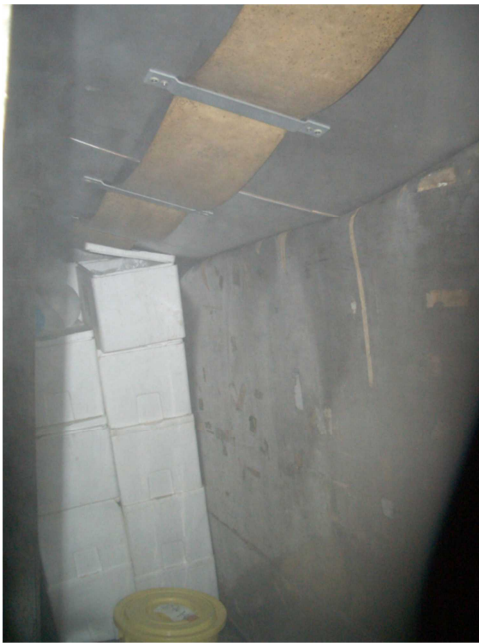
図-12 コンテナ天井部の変形（8月）
