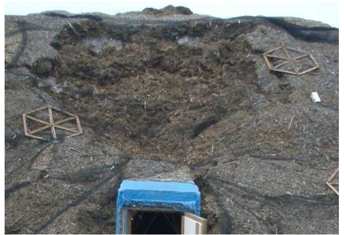
図-14 出入口上部の状況（8月）
