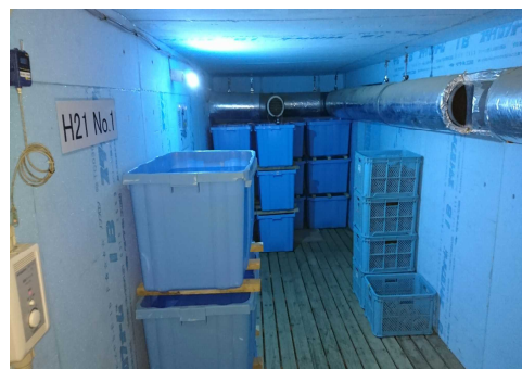
図 3-6 増設した貯蔵庫
