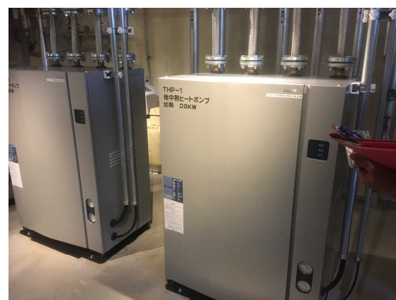
図4-2 ヒートポンプ施設
